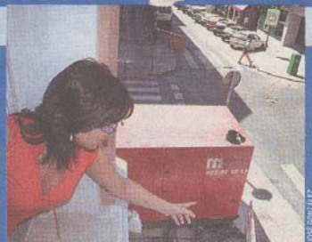
Los generadores están a pocos metros de las casas. JOSE DOMÍNGUEZ
